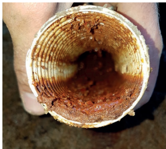
Kuva 3.39. Salaojaputki, johon on kertynyt ruostetta. Myös sora putken ympärillä oli ruosteen kovettama.
