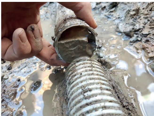
Kuva 3.38. Tukkeutunut salaojaputki hiuemaassa.
