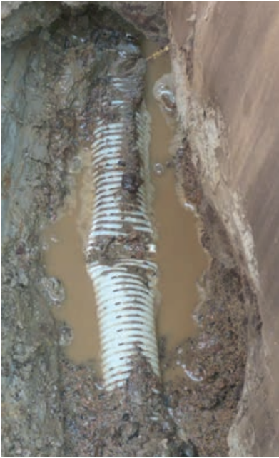
Rikkoutunut putki. (vas.)
