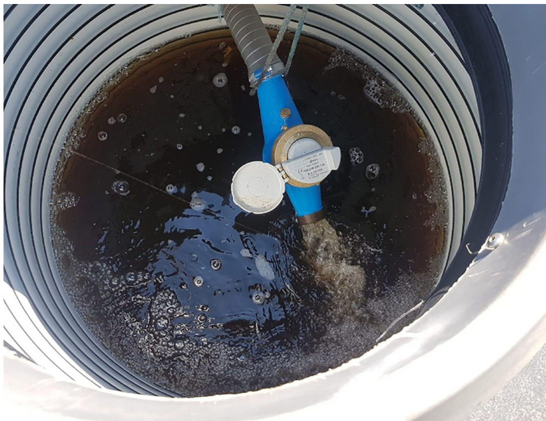
Kuva 6.3. Pohjavedenpinnan tasoa säädelään säätökaivon avulla. Altakastelussa säätökaivon kautta voidaan pumpata lisävetä ojastoon. (Kuva: Markus Sikkilä.)
