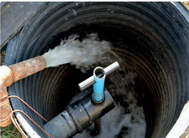
Figur 4.5. Underbevattning innebär i praktiken att vatten pumpas in i dikessystemet via en regler- eller bevattningsbrunn. Foto: Rainer Rosendahl
