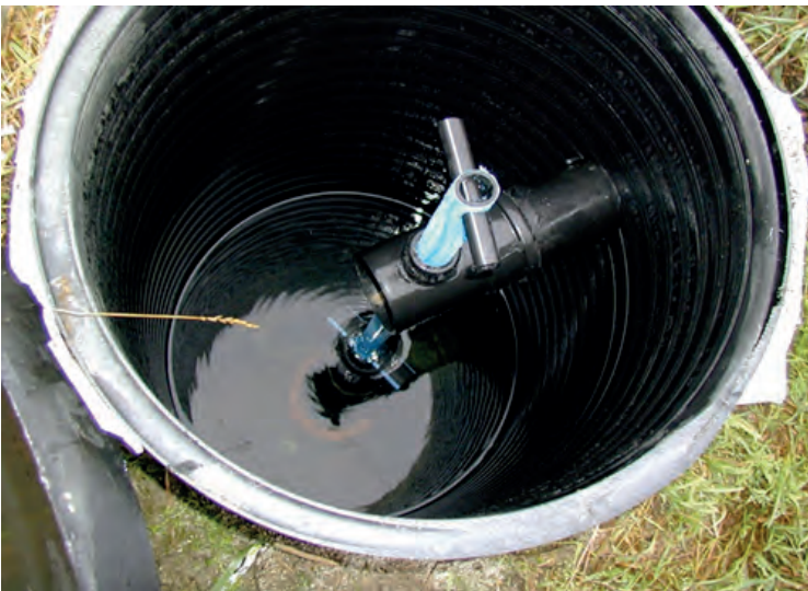
Figur 4.4. Dämmande dräneringsbrunn, dvs. reglerbrunn. Foto: Rainer Rosendahl
