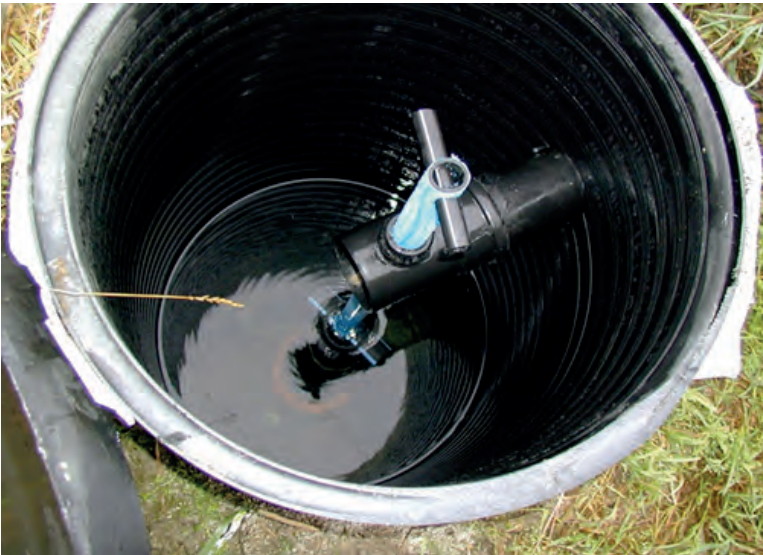
Kuva 4.4. Padottava salaojakaivo, eli säätökaivo. Kuva: Rainer Rosendahl
