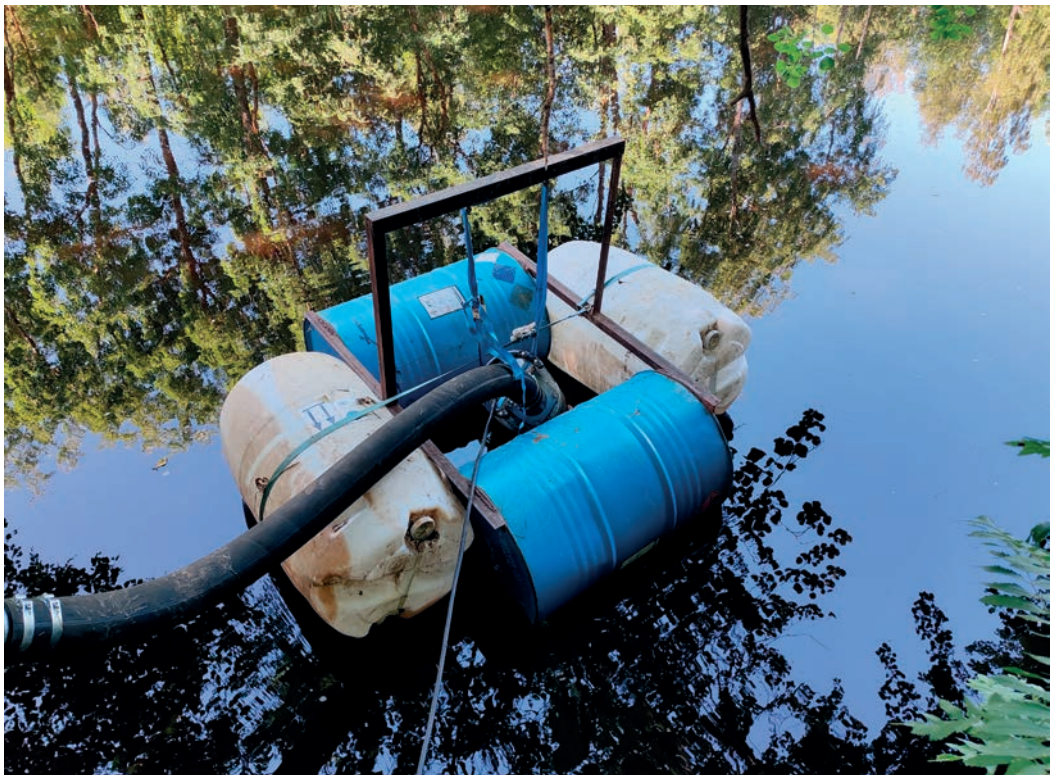
Kuva 36. Vesistöön lautalle asennettu 7,5 kW uppopumppu. Pumppua varten on erillinen sähköliittymä, ja sillä kastellaan noin 20 ha peltoaluetta. Pumpulta lähtevä runkolinja on 110 mm vesijohtoputkea ja se haarautuu myöhemmin eri ojastoille. Kuva: Antti Haho.
