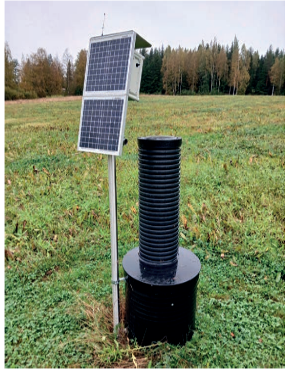
Kuva 33. Etäohjattava säätökaivo saa toimintaenergiansa aurinkopaneelista, joten se ei tarvitse yhteyttä sähköverkkoon. Tiedonsiirto tapahtuu mobiiliverkon kautta. Kuva: Jari Kolehmainen.
