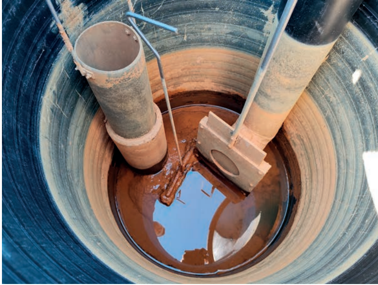
Kuva 49. Ruostesaostumia säätösalaojakaivossa. Kuva: Antti Haho.
