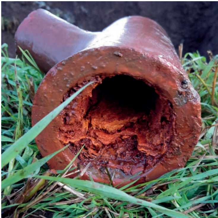
Kuva 30. Happamilla sulfaattimailla muodostuva ruoste saostuu salaojaputkiin, ja ajan myötä saattaa tukkia ne kokonaan. Tämä on merkittävin salaojituksen toimintaan liittyvä ongelma ns. ruoste-alueilla. Säättösalaajituksen avulla ruosteen saostumista voi hidastaa, joten ympäristöhyötyjen lisäksi säättösalaajitus parantaa ojaston toimintavarmuutta ja pidentää käyttöikää.
