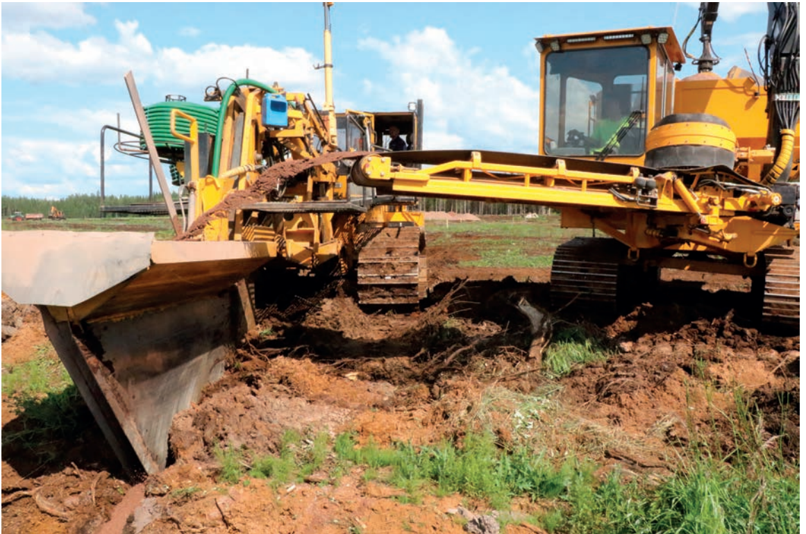
Kuva 48. Peltosalaojitukseen erikoistuneiden urakoitsijoiden käyttö salaojituksessa on suositeltavaa, sillä heillä on työhön tarvittava osaaminen ja laitteet. Salaojaurakoitsijoiden yhteystietoja löytyy maakunnittain esimerkiksi Salaojayhdistyksen sivuilta. Kuva: Seppo P.
